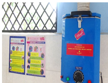
写真 8. 女子トイレに設置されたナプキン焼却装置
